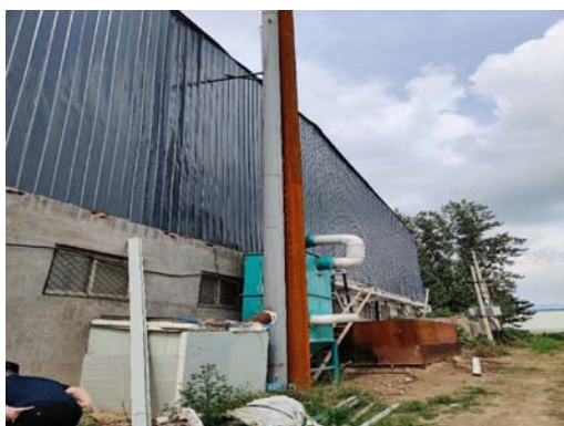
现有工程除尘设施
