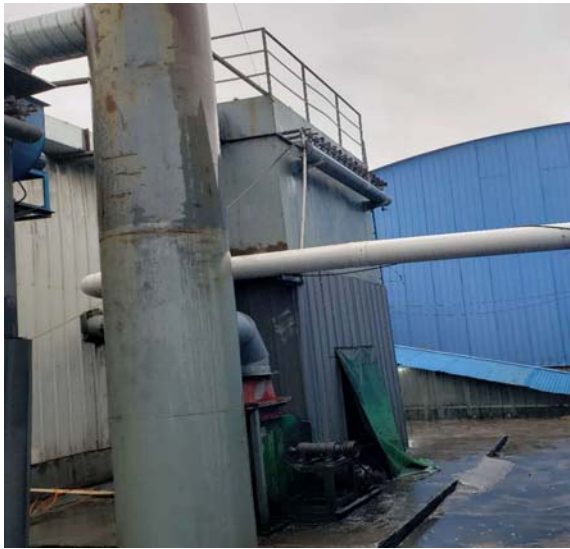
新增袋式除尘器
