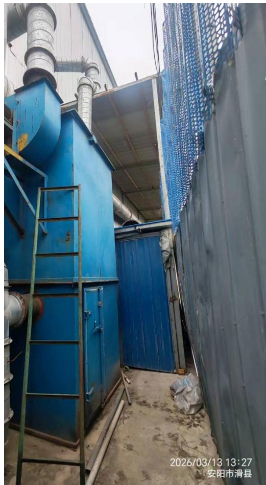
现有工程袋式除尘器
