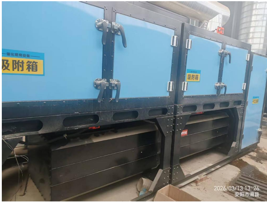
现有工程活性炭吸附脱附+催化燃烧装置
