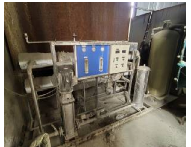
现有软水制备设施
