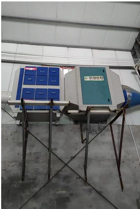
现有废气处理设施
