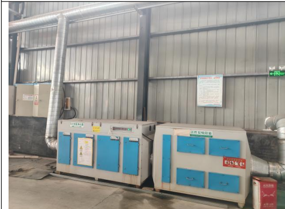
现有工程废气治理设施
