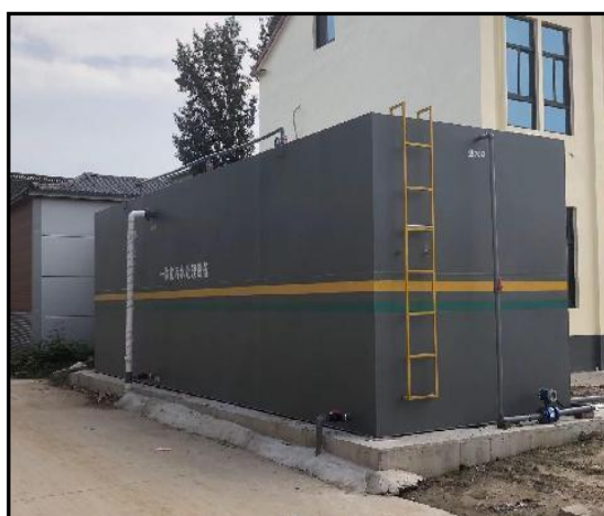
东安村污水处理站
